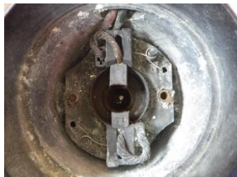
浸水したロウユニット内部
